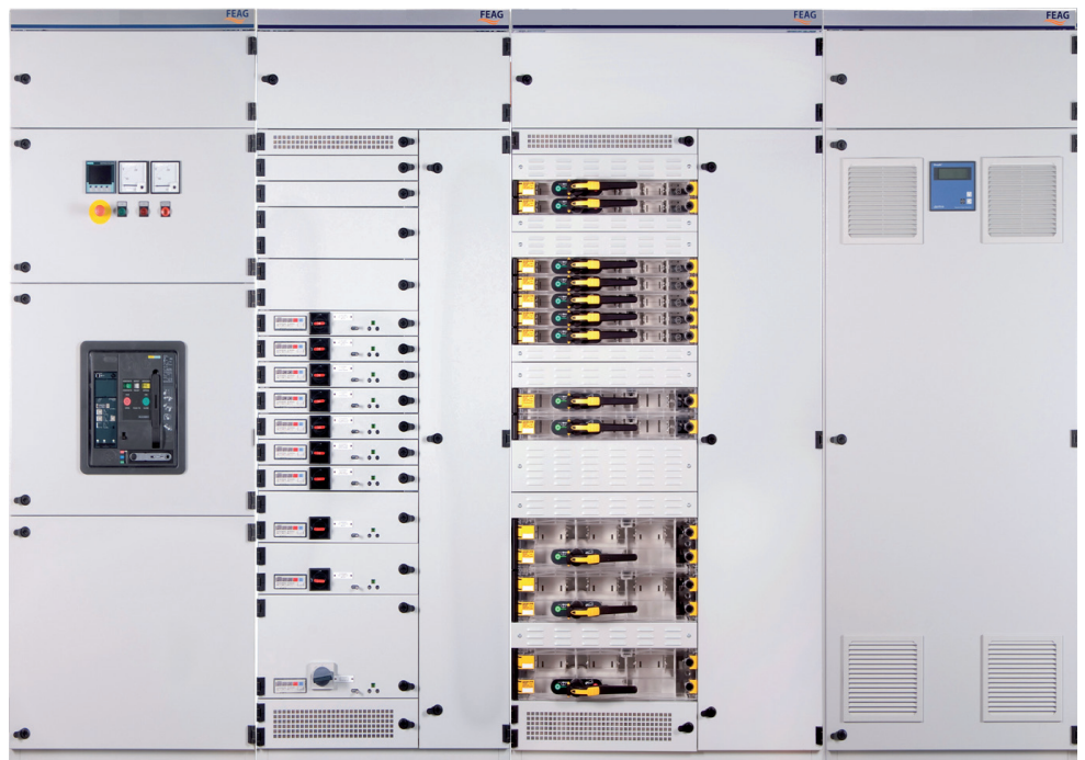
Bild 1. Das Schaltanlagen-System SPC mit Leistungsschalterfeld, Feld mit Volleinschubtechnik, Sicherungsleistenfeld und Kompensationsanlage
