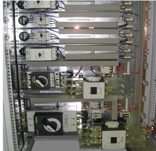
Verbraucher-Abgänge mit Leistungsschaltern und Schützen / Consumer feedings with circuit breakers and contactors
